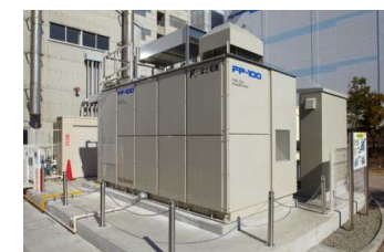
<燃料電池を利用したコージェネレーションシステム>
